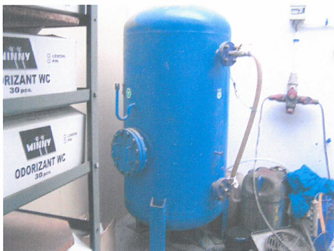
zbiornik sprężonego pow. 0,74 m 3
