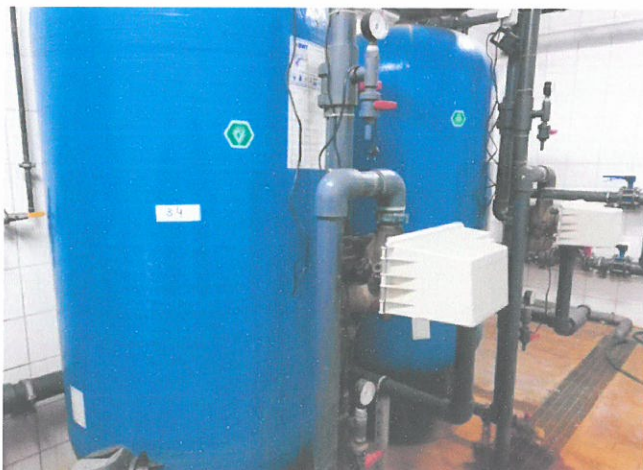
stacja uzdatniania wody/ inw.34
