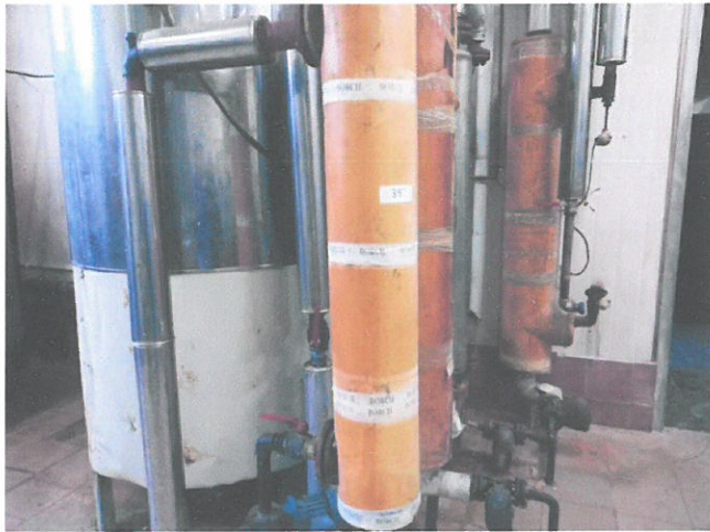
stacja wymiany ciepła/inw.35
