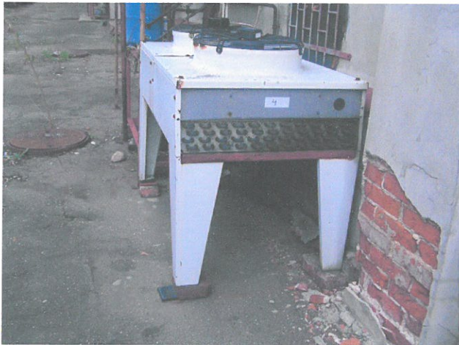
agregat do wytw.lodu/inw.4
